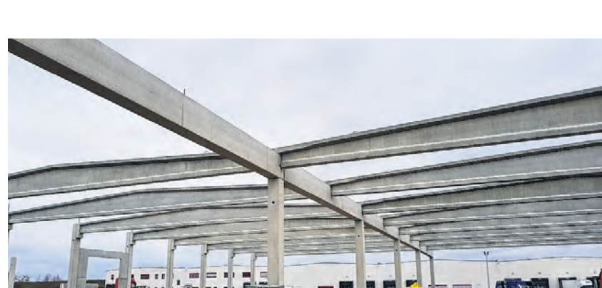
Beeindruckende Dimensionen hat die Halle, die das Fertigteilewerk Obermain für die Firma Beständig in Gochsheim errichtet hat.
