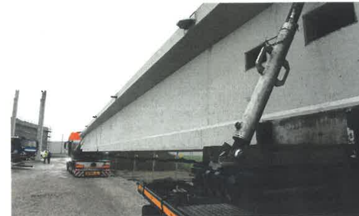
Die von FTO gefertigten Spann- betonträger wurden von Universal Transport auf mehreren Nachläuferkombinationen angeliefert.
